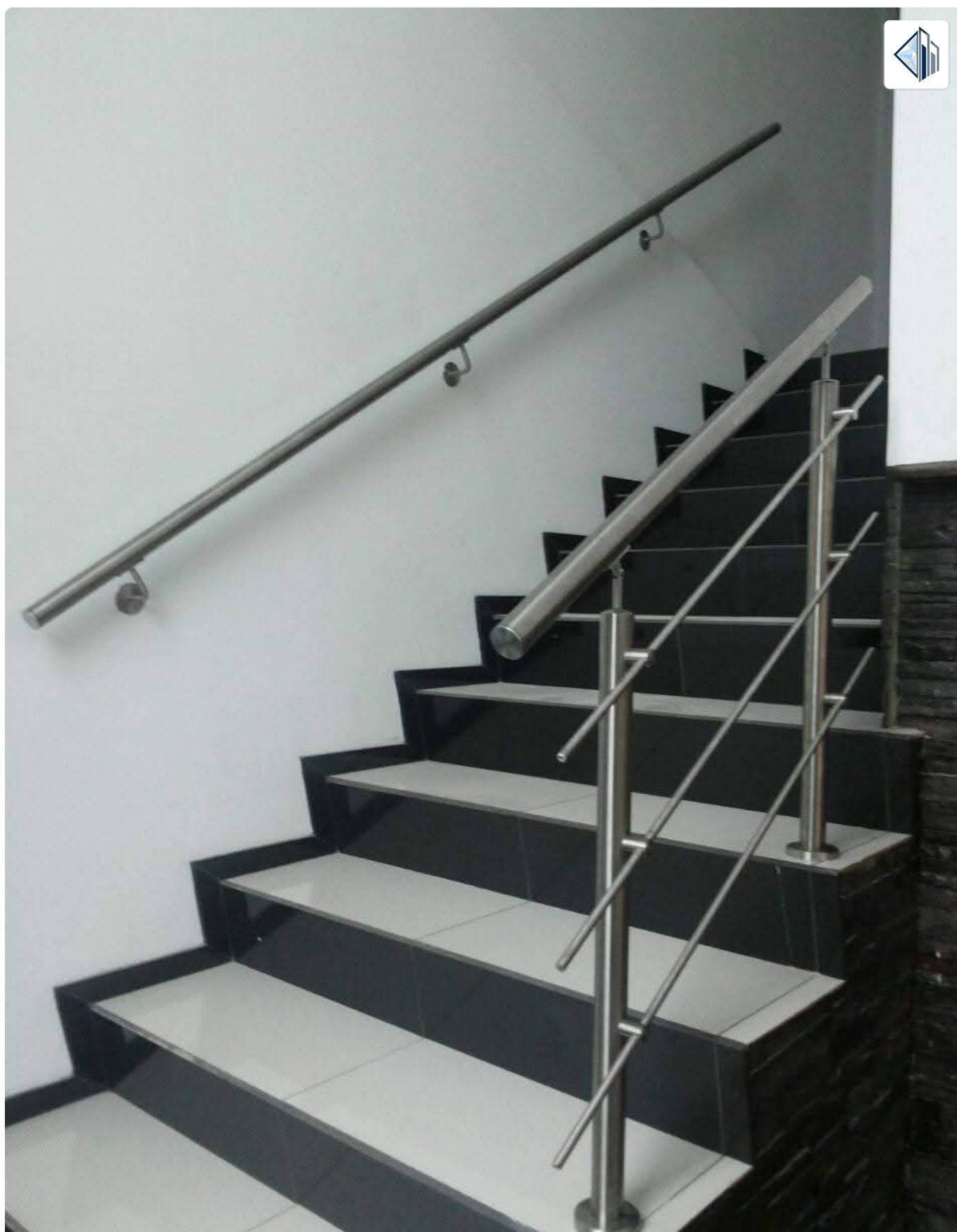
Doble pasamanos en acero inoxidable — escalera de dos tramos
