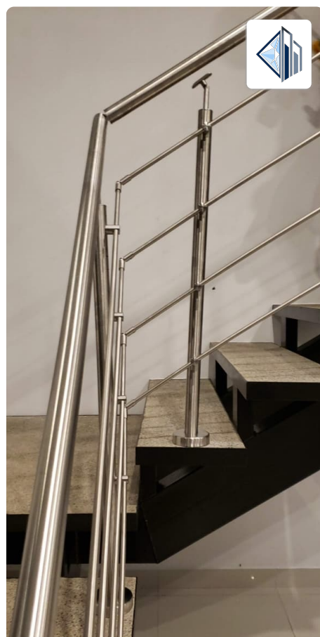
Detalle de poste y fijación
